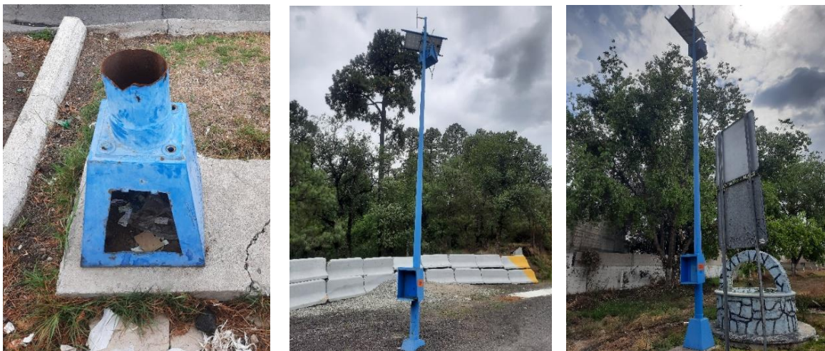
Imagen 3. Torres de Auxilio Vial vandalizadas y sin funcionar. Autopista México – Puebla km 40+500, 58+200 y 88+300.
