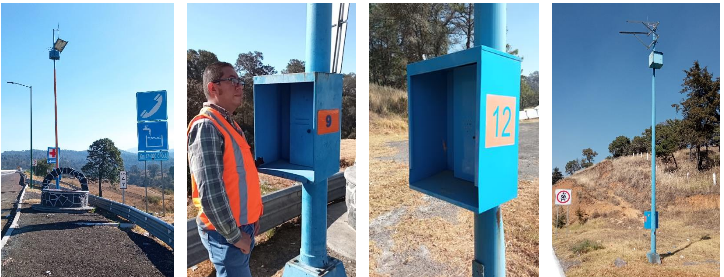
Imagen 3. Torres de Auxilio Vial 9 y 12 Autopista México – Puebla Clasificadas como Operativas: km 47+000 y 43+300.
