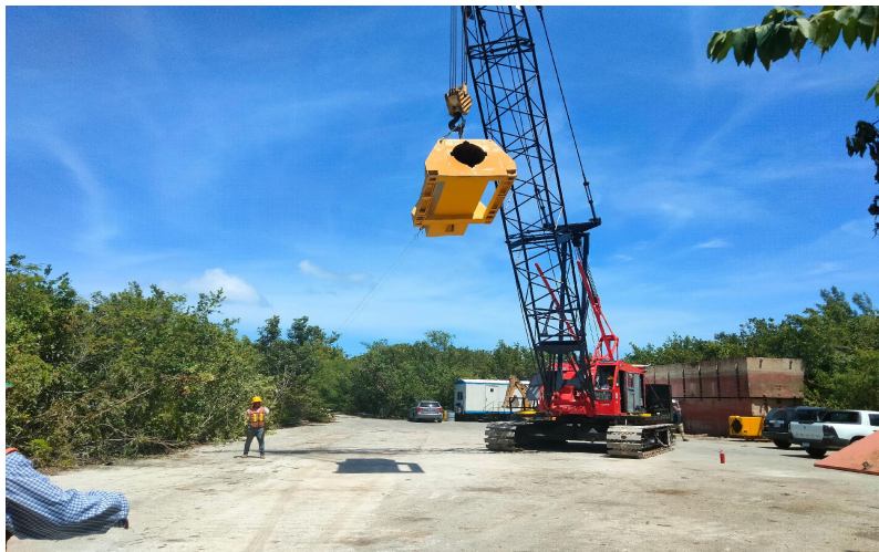
Ubicación: MUELLE TAJAMAR / T6 02 Actividad: proceso de lanzamiento de rampas y portazancos para barcazas
