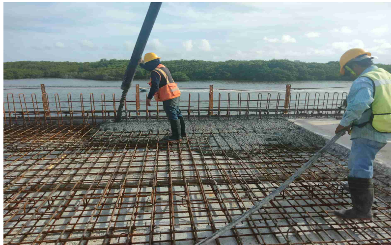
Ubicación: LOSAS DE CALZADA / T4 TAB074-075 LC Actividad: Inicia colado de losa de calzada claro 74.5-75.5, tramo 4 zona lagunar.
