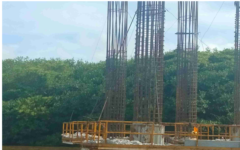
Ubicación: PILA Y COLUMNA 001 / T3 A60 P01 Actividad: Se inicia el armado de acero de refuerzo en columnas del apoyo 60, tramo 3 zona top down
